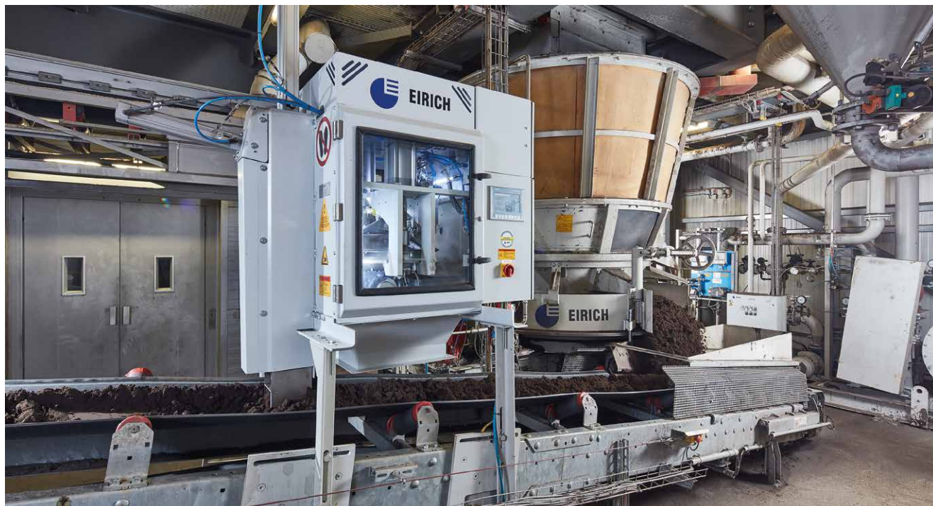
Bild 3: Eirich-Inline-Prüfsystem Quali-Master AT1, das Herzstück der Qualitätssicherung in der Formstoffaufbereitung.
